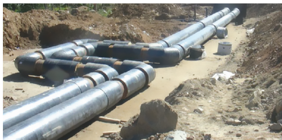
Şəkil 2 Boruların "Π" formasında birləşdirilmiş hissəsi
